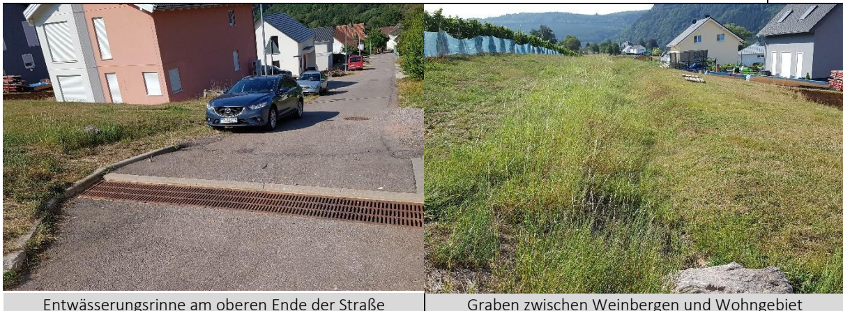
Entwässerungsrinne am oberen Ende der Straße
