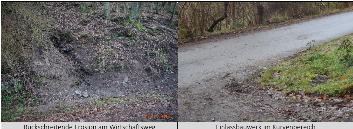
Rückschreitende Erosion am Wirtschaftsweg
