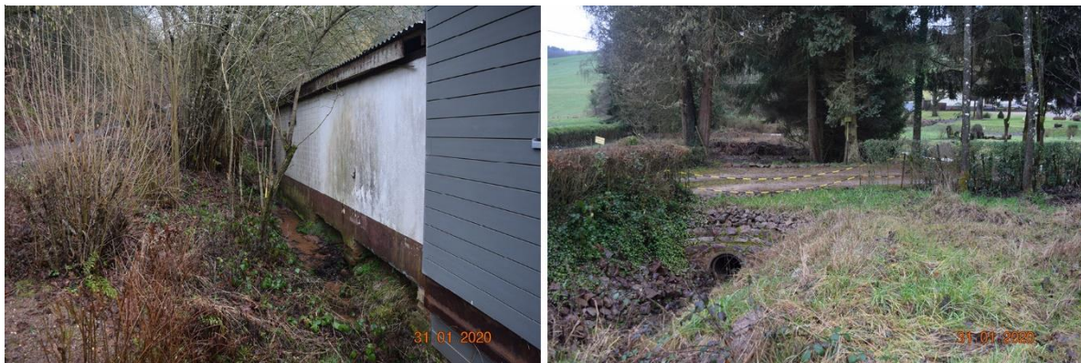
Abb. 25: Bedrohtes Haus am Waldfriedenbach und erneuerter Wegedurchlass
