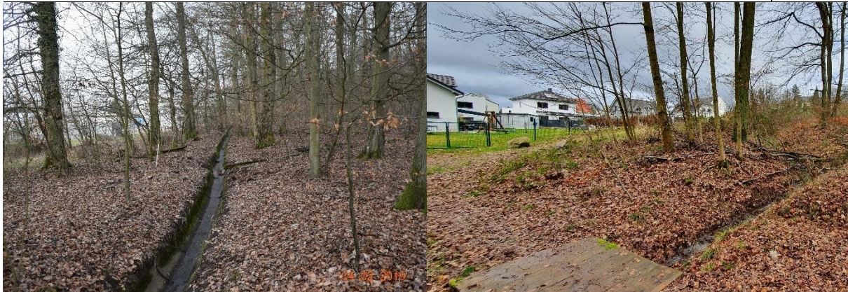
Entwässerungsrinne entlang des Tectro-Geländes
