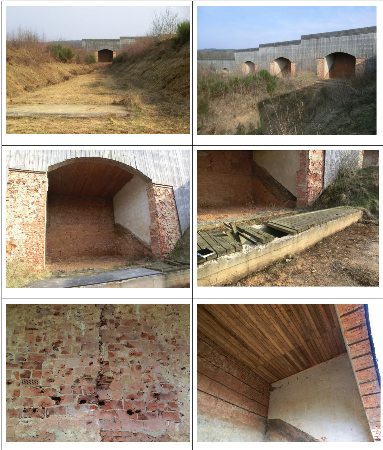
Abbildung 3: Die Gewehrschießstände im Planungsgebiet mit den davor liegenden Erdwällen (oben). Vor den Kugelfängen des Gewehrschießstandes befinden sich unterirdische Laufgänge (mitte). Diese, ebenso wie zahlreiche Einschlagslöcher in den Wänden der Kugelfänge und die Holzverkleidung an der Decke (unten), stellen potenzielle Quartiere für Fledermäuse dar.
