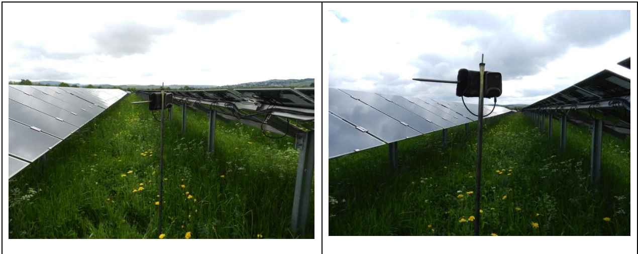
Abbildung 38: batcorder in der Photovoltaik-Anlage in Föhren (Landkreis Trier-Saarburg)-
